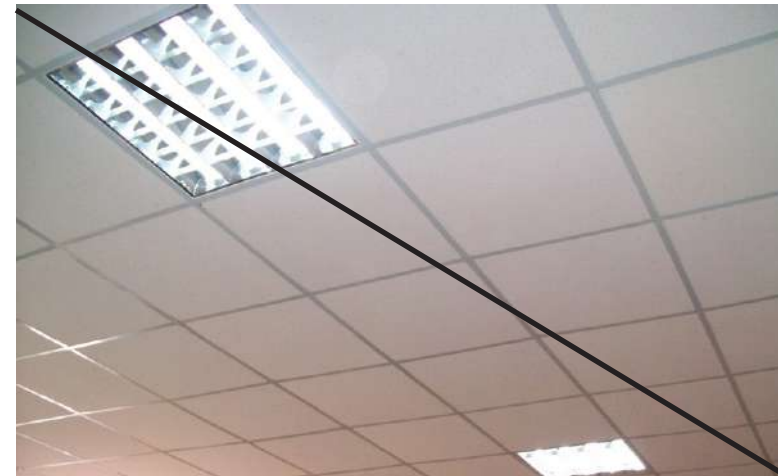
Плохо Открытые направляющие
