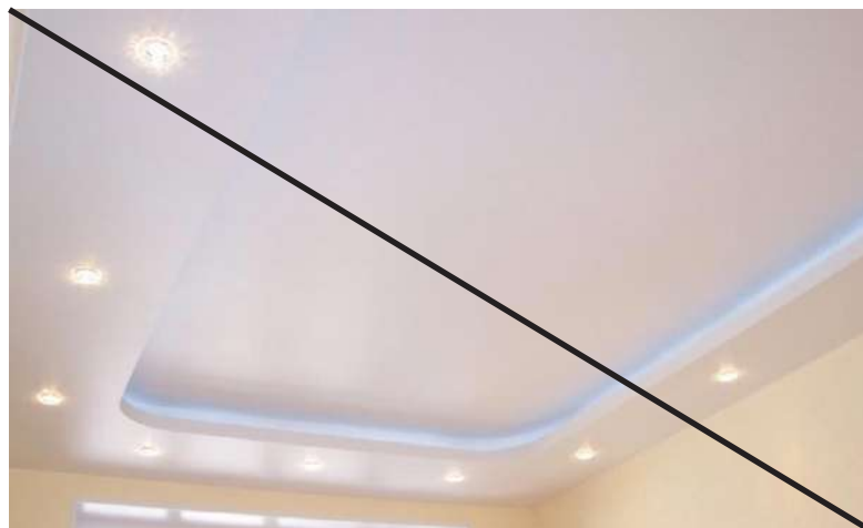
Плохо Многоуровневые гипсокартонные конструкции
