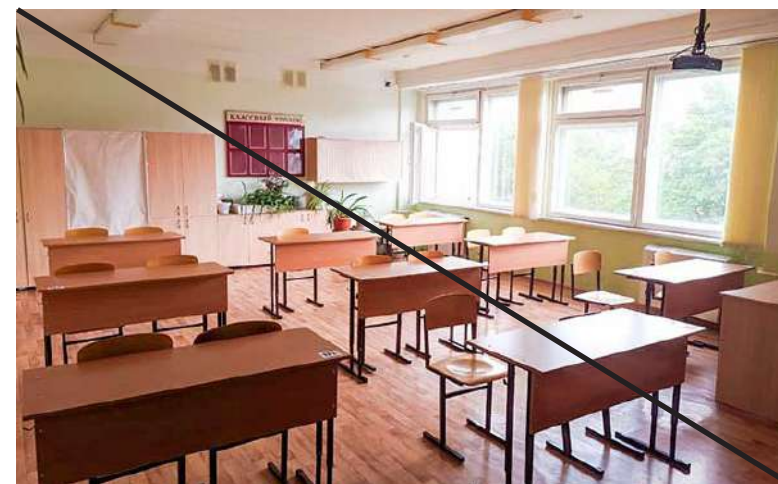
Плохо Линолеум под дерево
